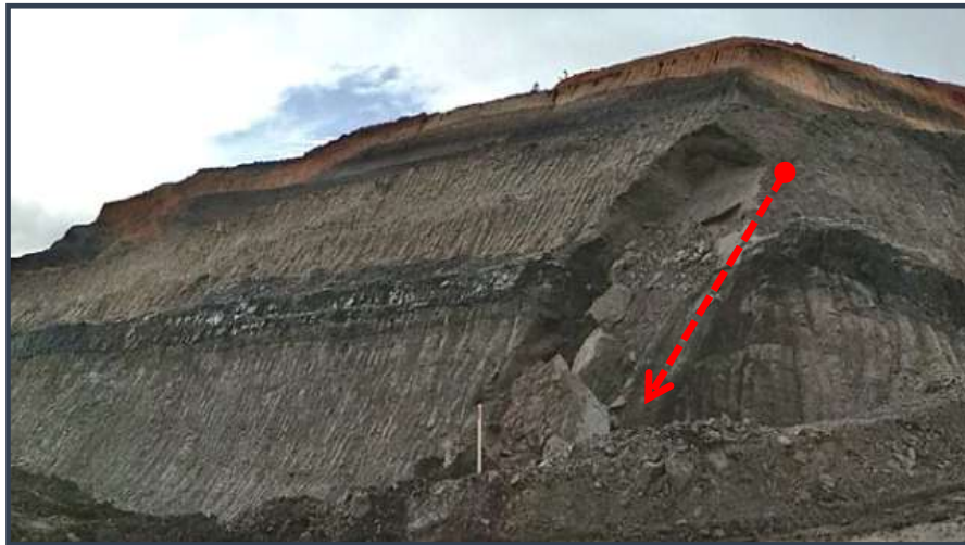
Gambar 2. Indikasi bidang patahan pada longsor lokal ( Minor ) High-wall (Pra-Longsor)
